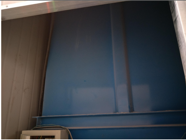
切割生产线布袋除尘器（内部照片）
