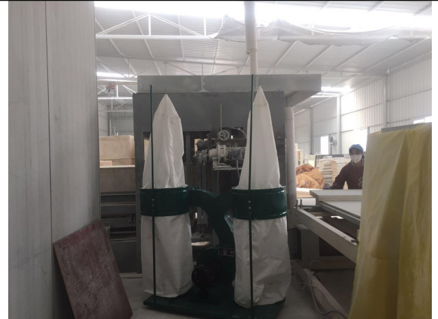
切割生产线双筒除尘器（1）
