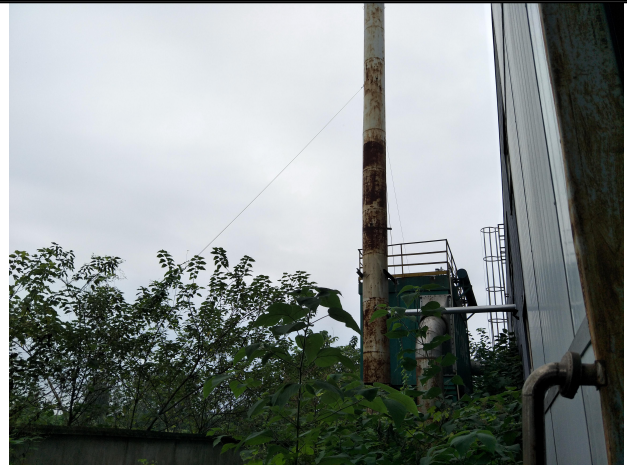
活性炭处理装置排气筒（与中央除尘器共用）
