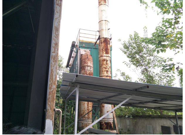
保温装饰一体板生产线中央除尘器及排气筒（1）
