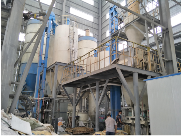
粘胶剂生产线仓筒、投料、包装及除尘设备
