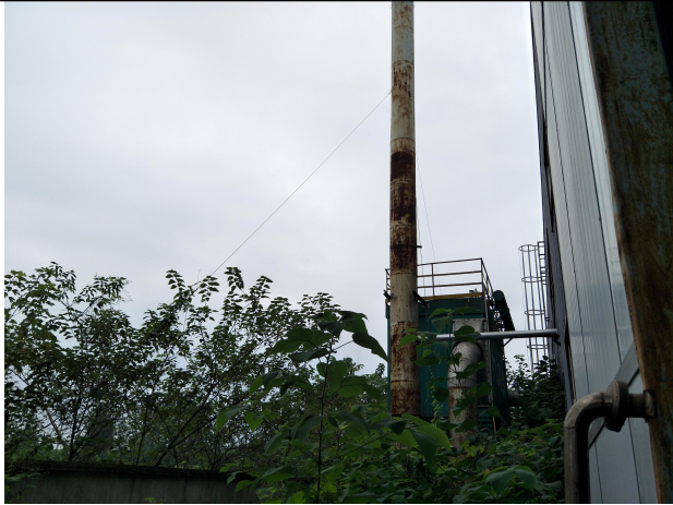
保温装饰一体板生产线中央除尘器及排气筒（2）
