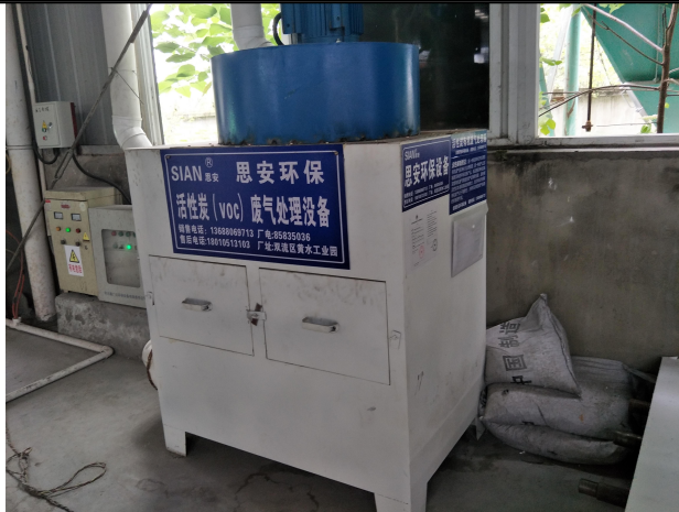
有机废气活性炭处理装置
